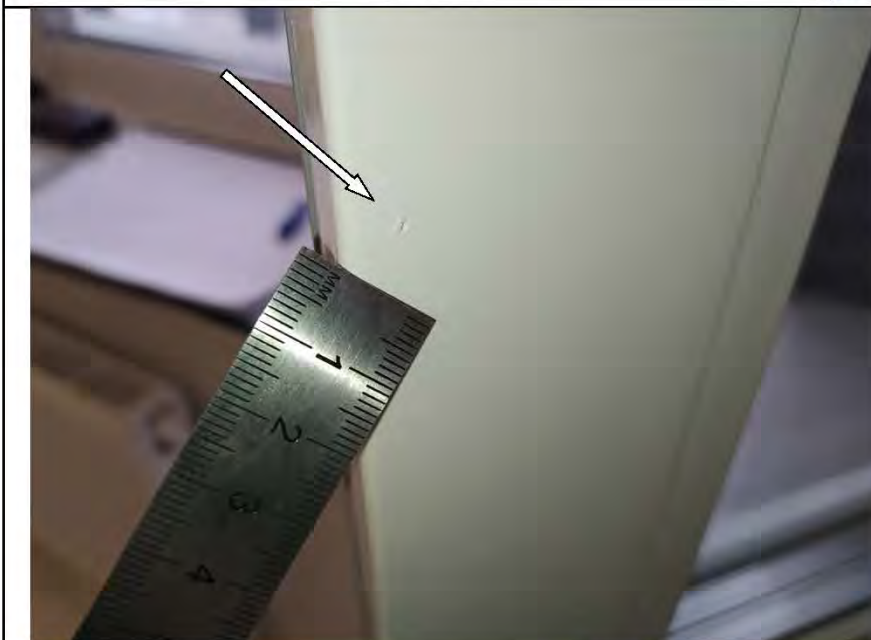
Фото №20. Профиль ПВХ оконно-дверного блока в спальне имеет дефекты (скол).
