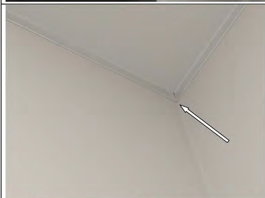
Фото №65. Дефект монтажа декоративного молдинга натяжного потолка в прихожей.
