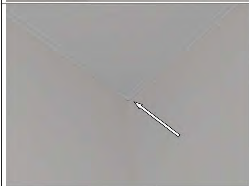
Фото №63. Дефект монтажа декоративного молдинга натяжного потолка в спальне.
