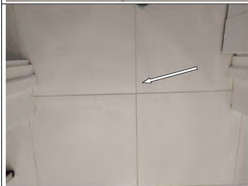
Фото №54. Затирка напольной плитки выполнена с нарушениями в ванной комнате: разность ширины шва.
