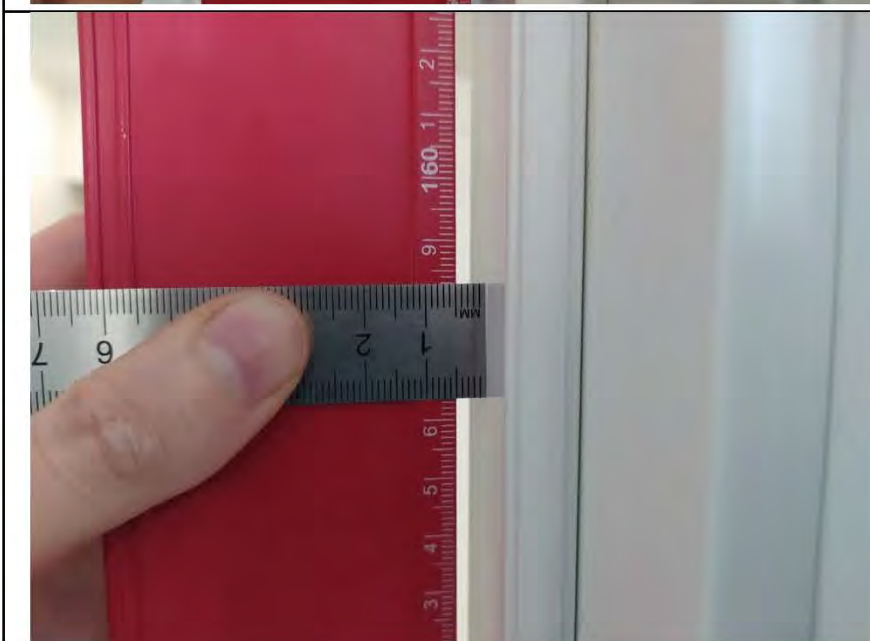
Фото №39. Отклонение коробки дверного блока в кухне.
