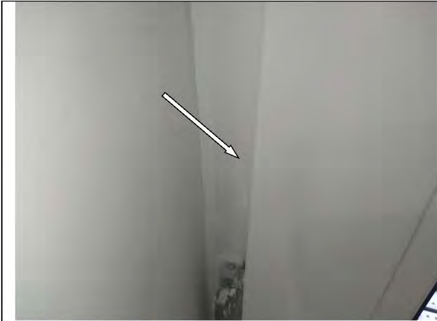
Фото №19. Профиль ПВХ оконного блока в кухне имеет дефекты (загрязнение малярными составами).
