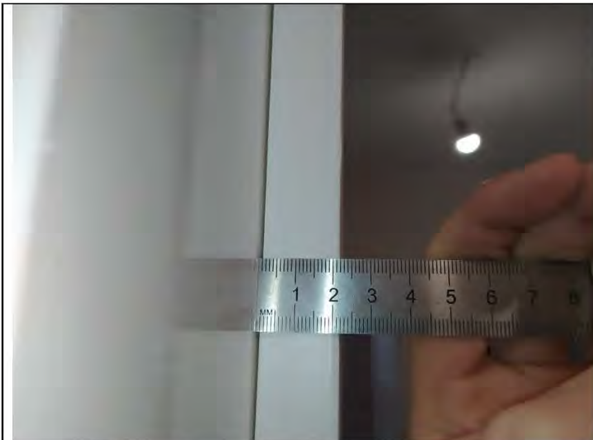
Фото №46. Элементы дверного блока соединены не надежно в ванной комнате.
