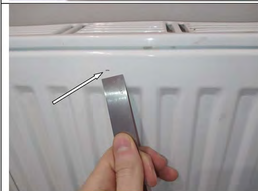
Фото №33. Отопительный прибор имеет дефект покраски защитного кожуха в кухне (скол).
