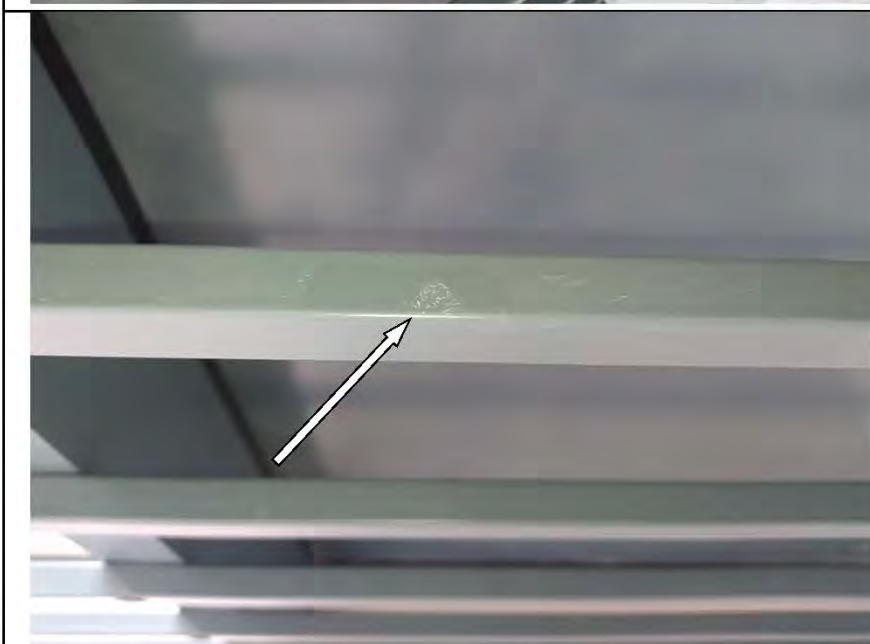
Фото №32. Дефект металлического профиля ограждения лоджии (стертости).
