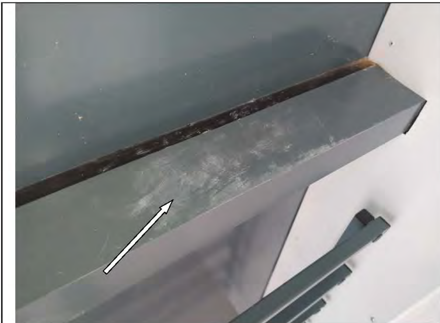
Фото №31. Дефект на металлическом профиле оконного блока на лоджии (стертости).
