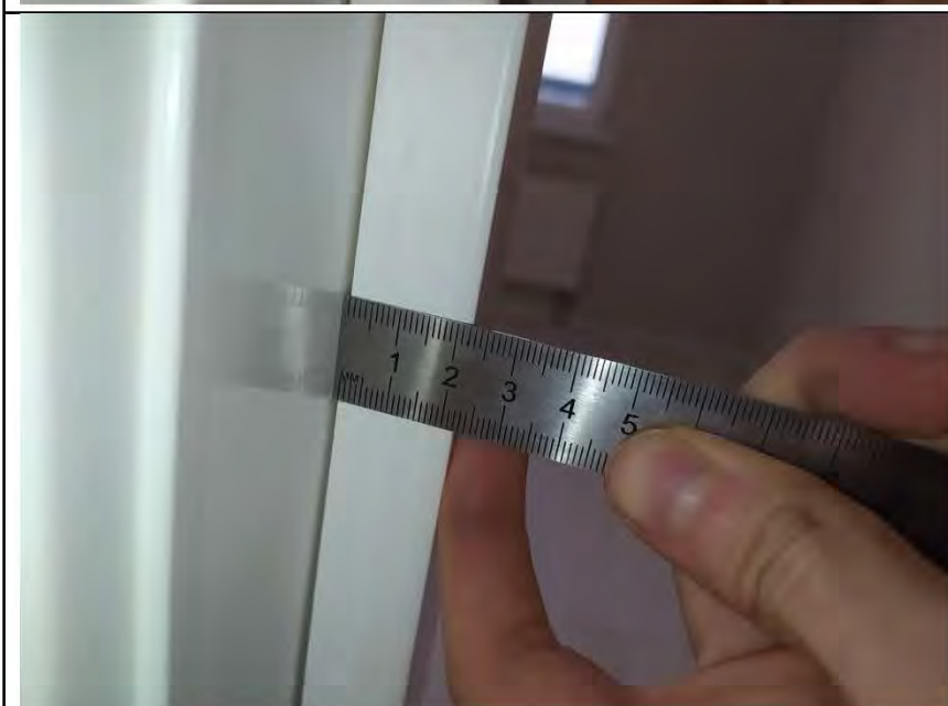
Фото №45. Элементы дверного блока соединены не надежно в гостиной.
