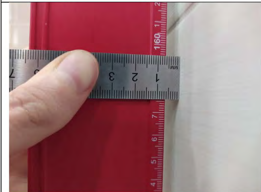
Фото №11. Измерения уровня стен в ванной комнате.
