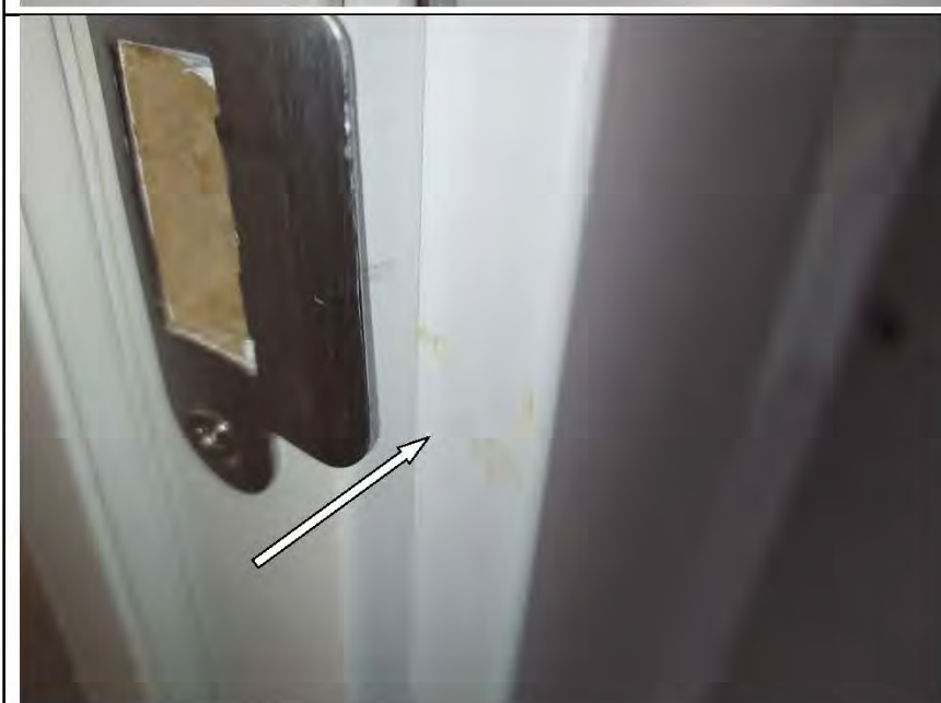
Фото №42. Коробка деревянного дверного блока в гостиной имеет дефекты (загрязнение монтажной пенной).
