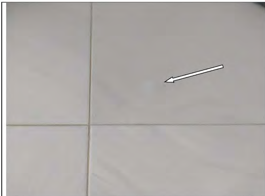
Фото №58. Загрязнение затирочным раствором напольной керамической плитки на лоджии.
