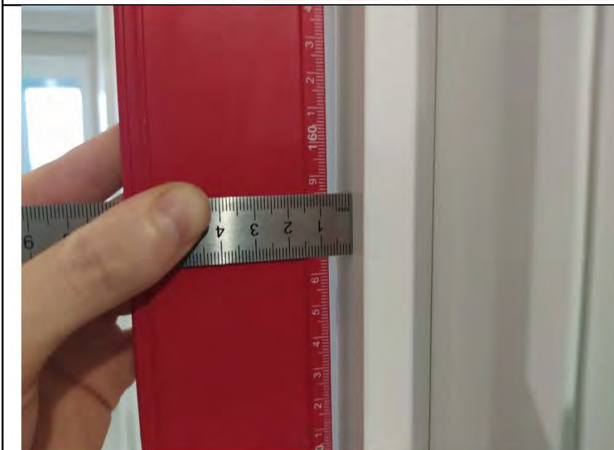
Фото №38. Отклонение коробки дверного блока в гостиной.
