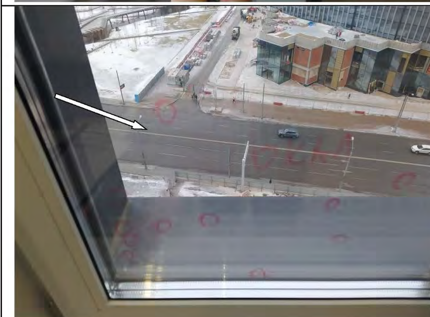
Фото №24. На стеклопакете оконного блока ПВХ в кухне имеется дефект (окалина).
