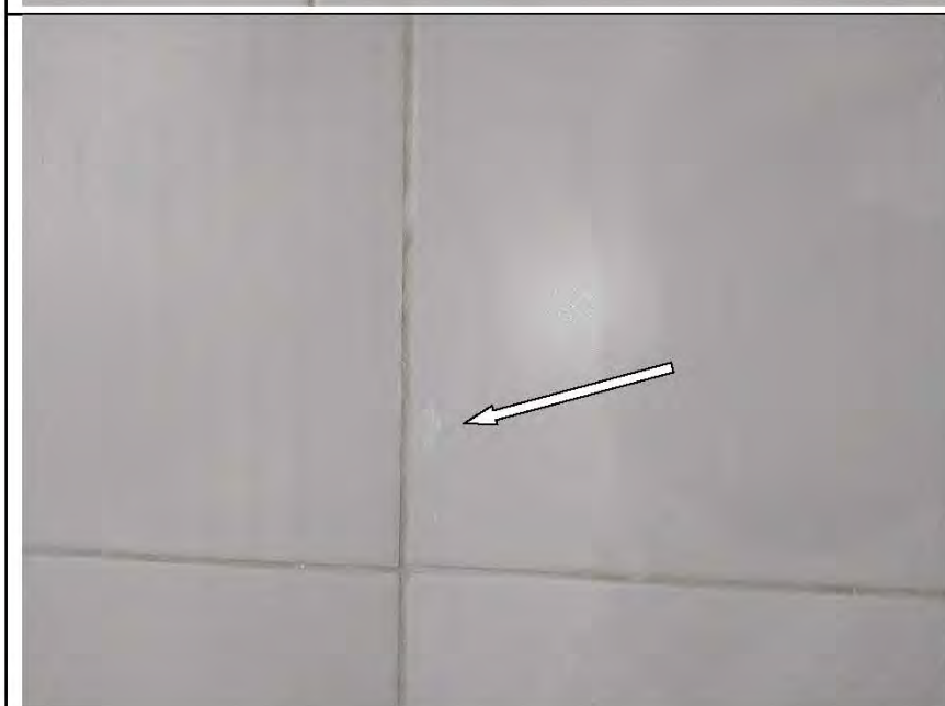
Фото №59. Загрязнение затирочным раствором напольной керамической плитки в кухне.
