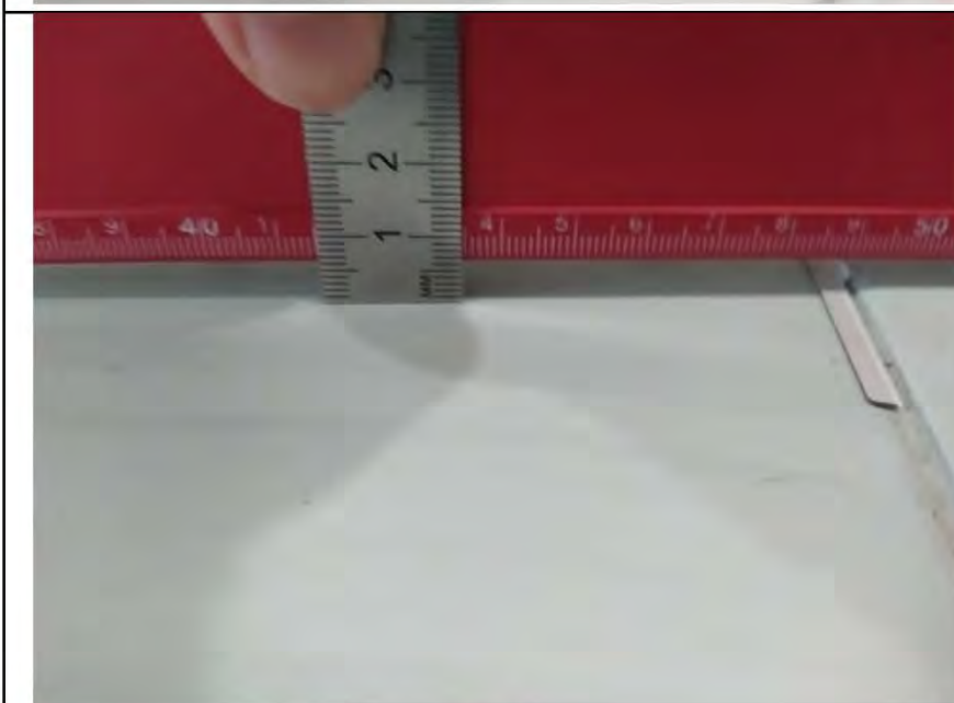
Фото №14. Измерения уровня напольного покрытия в прихожей (керамическая плитка).
