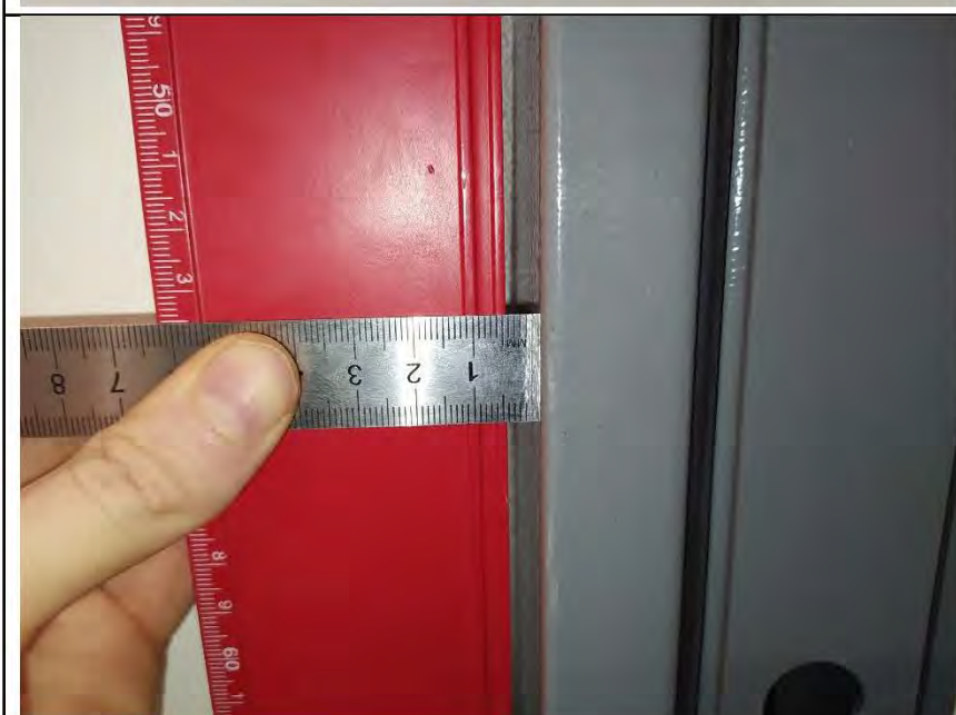
Фото №66. Отклонение коробки входного дверного блока
