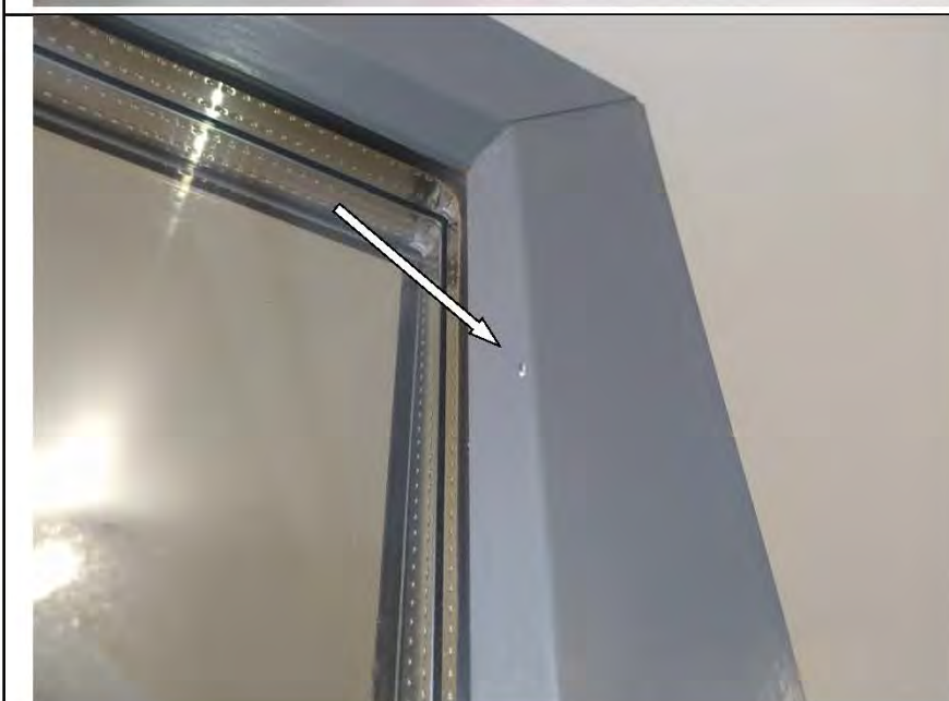
Фото №18. Профиль ПВХ оконного блока в кухне имеет дефекты (скол).
