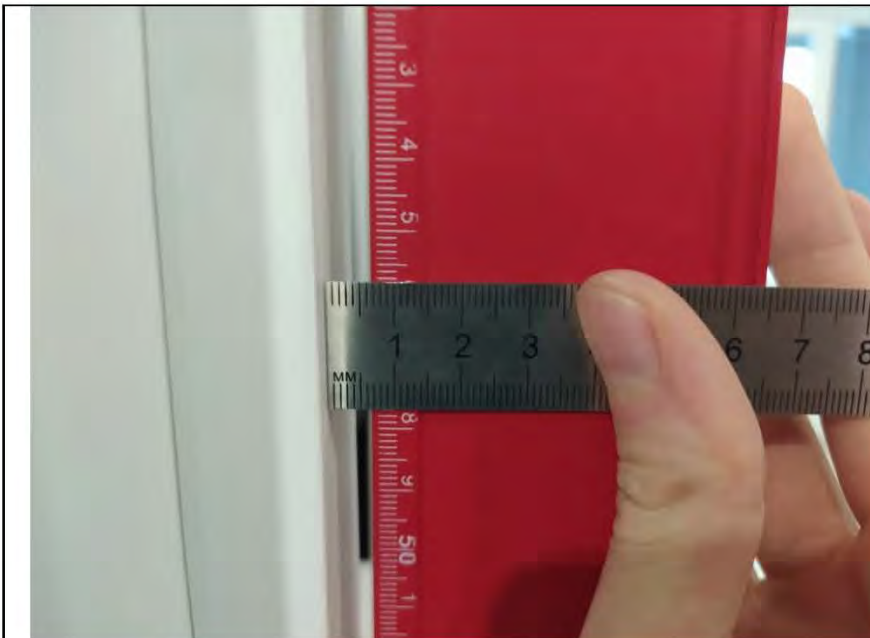
Фото №37. Отклонение коробки дверного блока в спальне.
