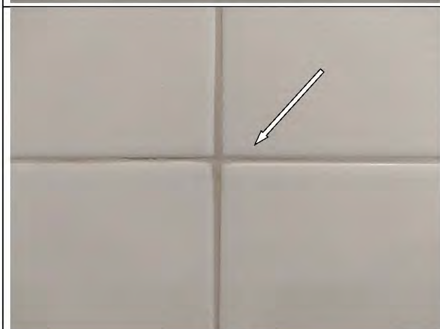
Фото №53. Затирка настенной плитки в ванной комнате выполнена с нарушениями.
