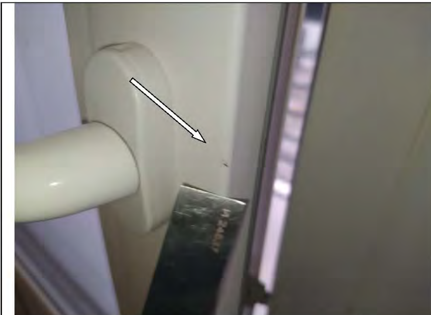
Фото №22. Профиль ПВХ оконно- дверного блока в гостиной имеет дефекты (скол).
