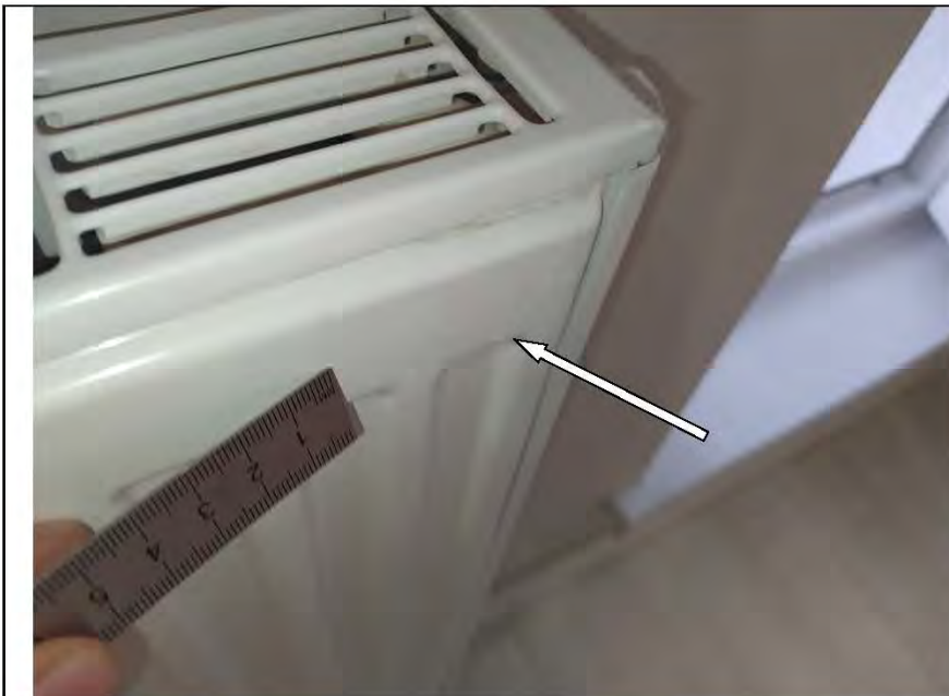
Фото №34. Отопительный прибор имеет дефект покраски защитного кожуха в спальне (царапины).
