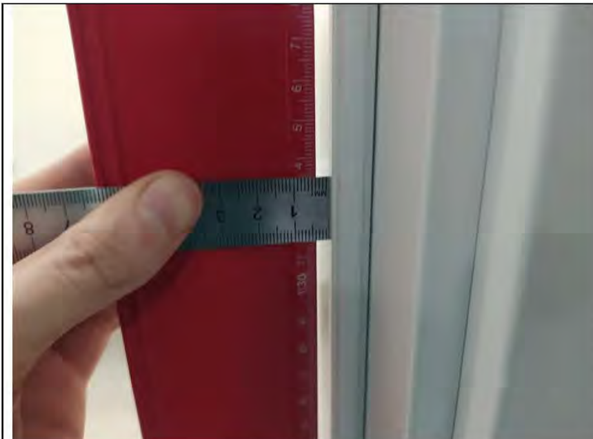
Фото №40. Отклонение коробки дверного блока в ванной комнате.
