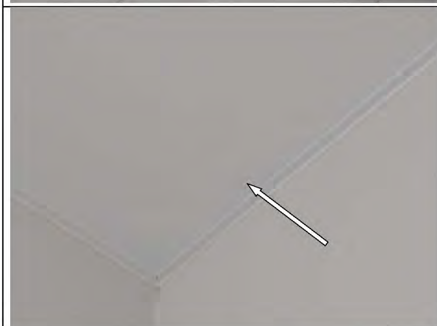
Фото №62. Дефект монтажа полотна натяжного потолка в кухне.
