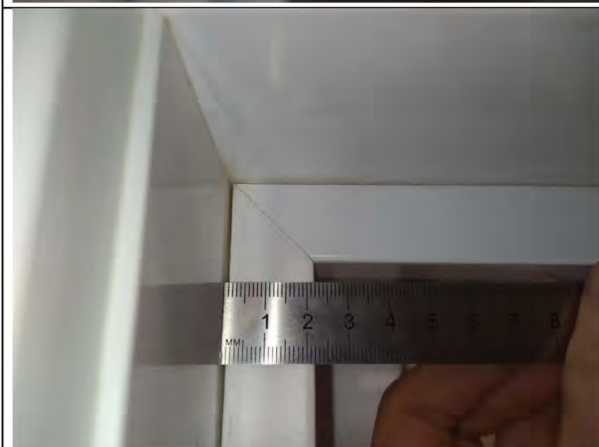
Фото №44. Элементы дверного блока соединены не надежно в спальне.
