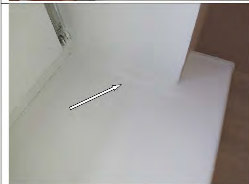
Фото №29. На лицевой поверхности подоконной доски в гостиной имеются дефекты (загрязнение малярными составами).
