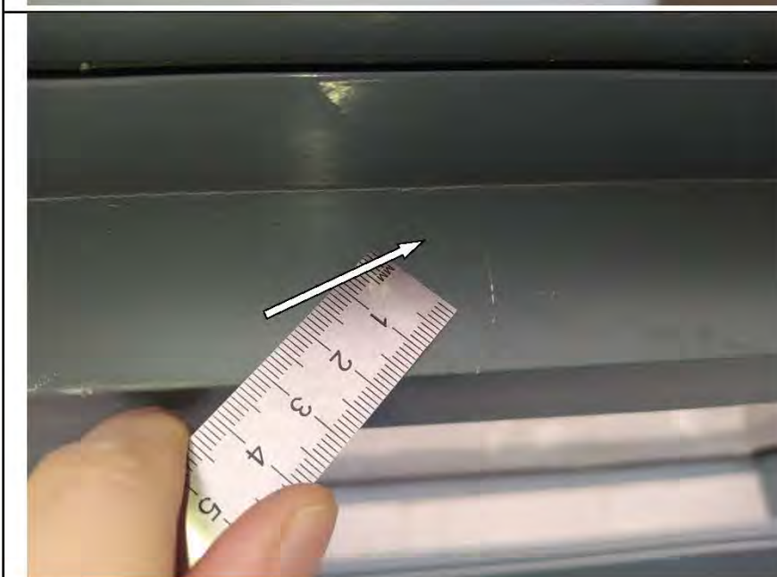
Фото №30. Дефект на металлическом профиле оконного блока на лоджии (царапина).
